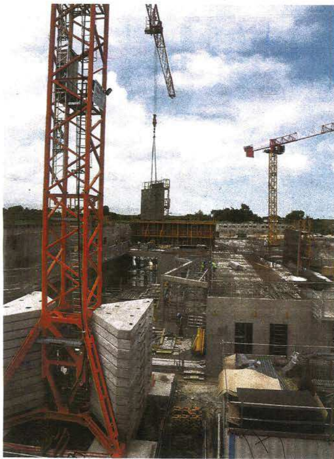
Le CHU est conçu pour résister à un séisme majeur et un cyclone extrême. (Photo : Roberto Birhus)
