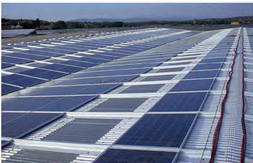
Impresa Pizzarotti L'impianto installato sulla copertura dello stabilimento di Lucignano (Arezzo).
